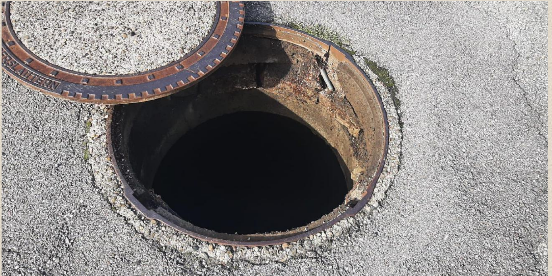
Schachtdeckel im Garagenhof Berner Straße, Gussrahmen gebrochen
